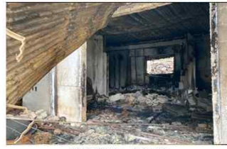
화재로 인해 소실된 주택
